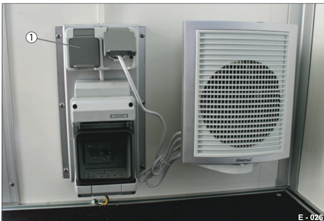
Abb. 8 Verteilerkasten mit Steckdosen
